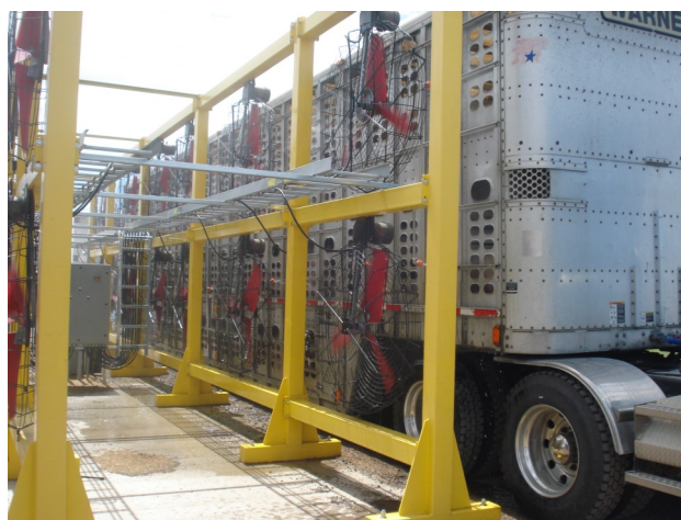
Système de ventilation. Source : Centre de recherche et de développement de Sherbrooke, AAC
